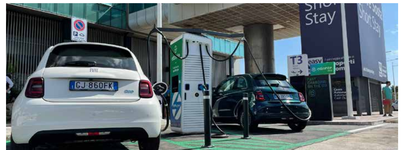
Nuove colonnine elettriche fast charge.
