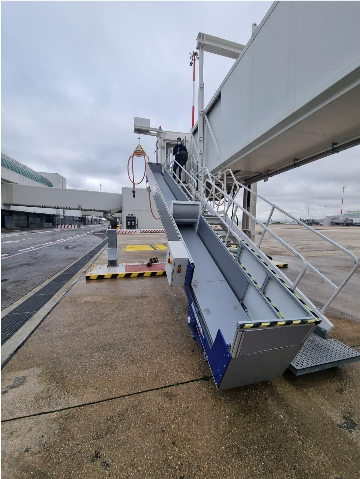
Immagine 1. Scivolo motorizzato installato presso un pontile di imbarco, quota pista
